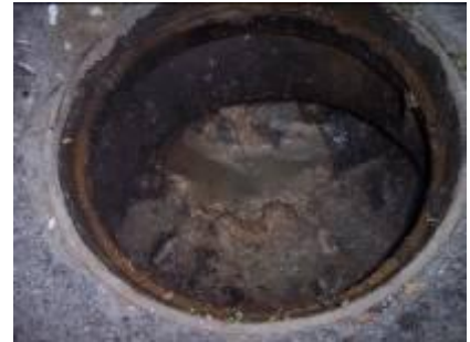
Las grasa tapan las tuberías sanitarias
